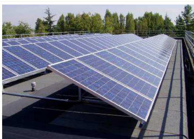
Fig. 28- Pannelli solari tipo
